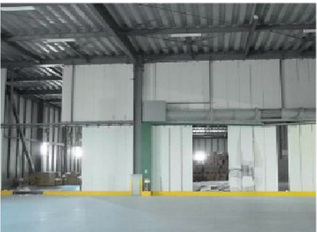
2段積みALC間仕切壁の被害事例
